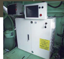
シールド制御・操作盤
