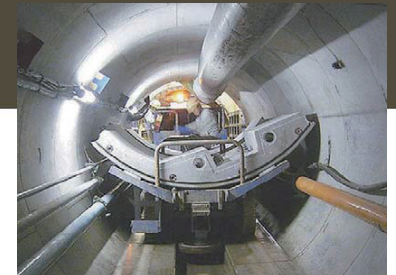
セグメント坑内搬送システム
