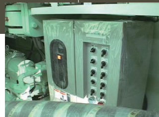
ロータリーポンプ制御盤
