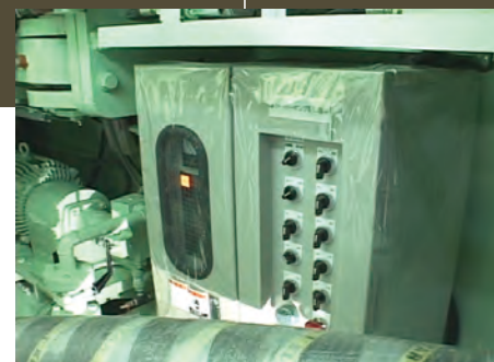
ロータリーポンプ制御盤
