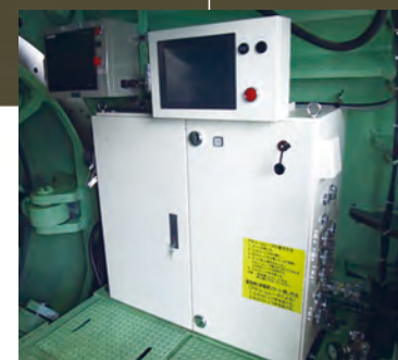
シールド制御・操作盤
