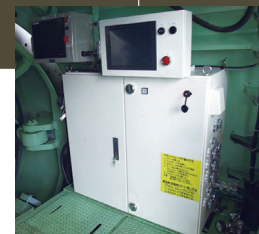
シールド制御・操作盤
