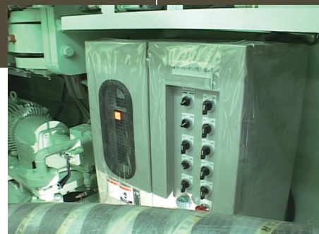
ロータリーポンプ制御盤
