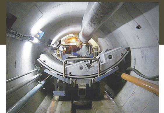
セグメント坑内搬送システム
