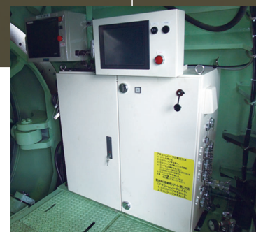
シールド制御・操作盤
