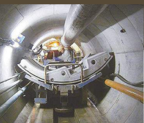
セグメント坑内搬送システム
