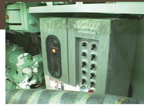
ロータリーポンプ制御盤
