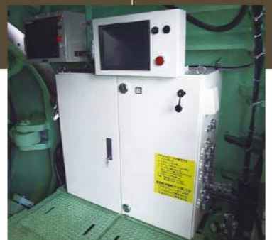
シールド制御・操作盤
