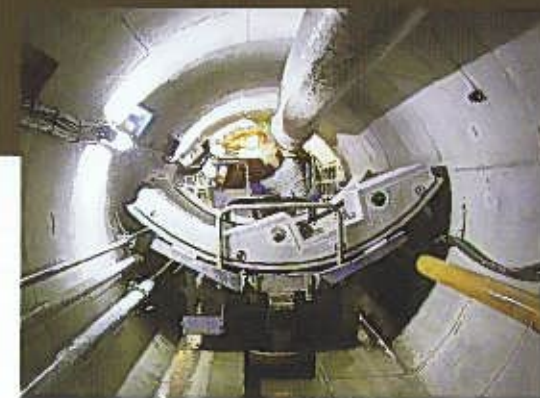
セグメント坑内搬送システム
