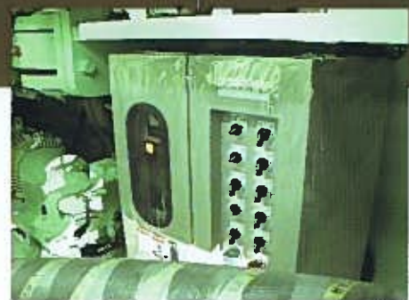
ロータリーポンプ制御盤
