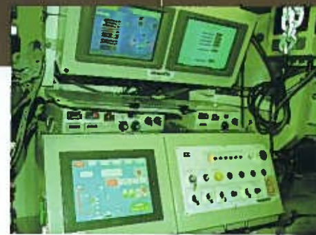
シールド制御・操作盤
